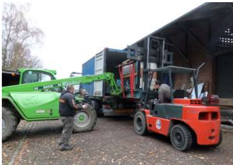
Chargement du groupe électrogène 200 kva
